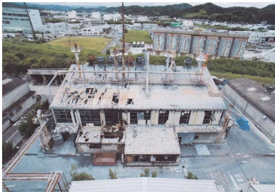
爆発事故後の 工場建物の外観
