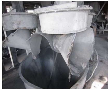
レシーバータンク (マルチサイクロン下)
