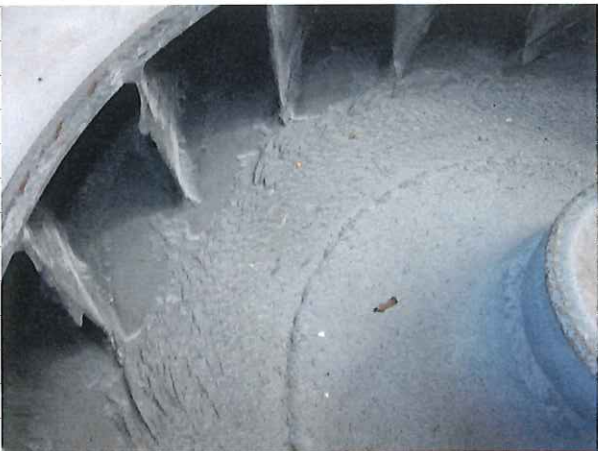
写真-3. インペラ近接スケール付着状況
