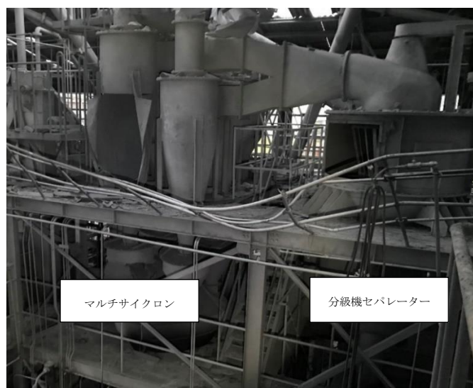
図26 分級機セパレーターおよびマルチサイクロン胴部破損
