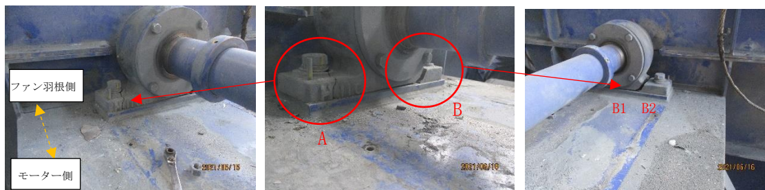
図 2 0 ベアリングボックスの破断状況
