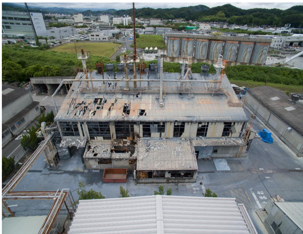
図9 損傷した工場建物の外観写真
